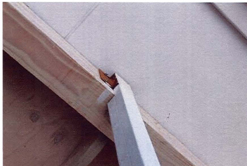
Fotografía 3, pletina conexión estructura de cabina de audio.
