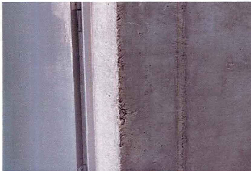
Fotografía 2, nidos de piedra en el hormigón.
