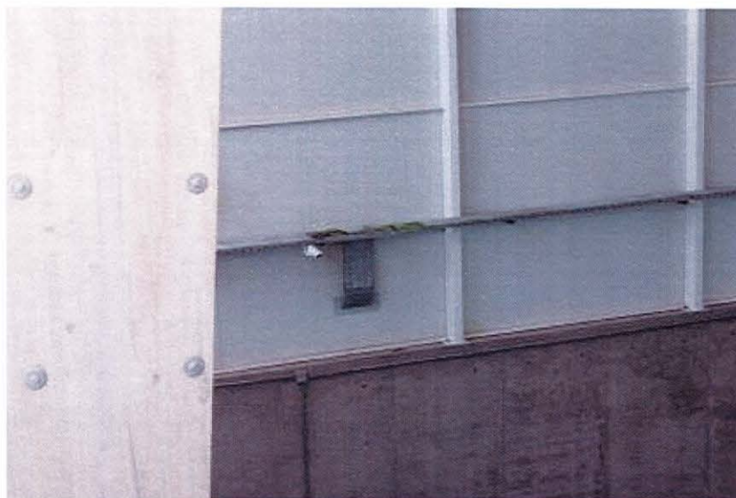
Fotografía 6, ausencia de tapa en conductor eléctrico.
