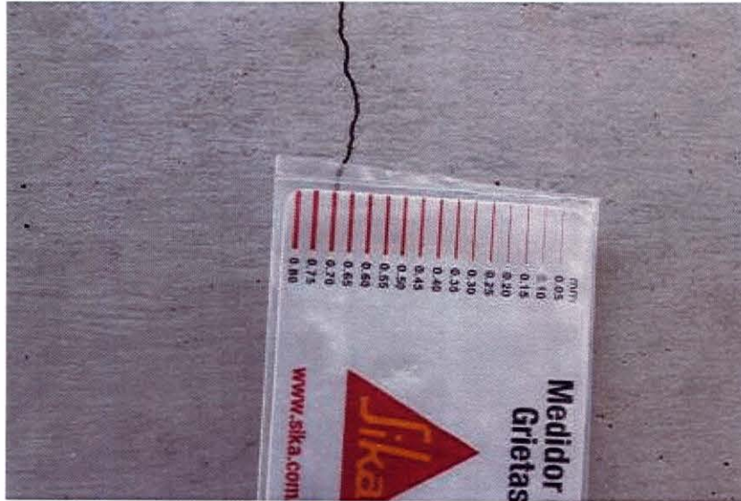
Fotografía 10, grietas muro contorno cancha.
