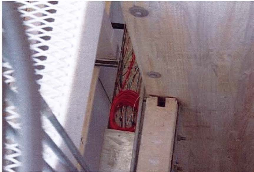
Fotografía 5, ausencia de tapa en conductor eléctrico.
