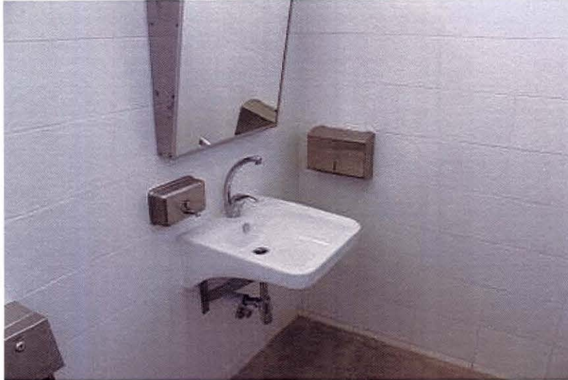
Fotografía 7, grifería servicios higiénicos espectadores con deficiencias de instalación.
